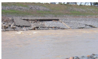
庄川堤防護岸欠壊及び根固流出
